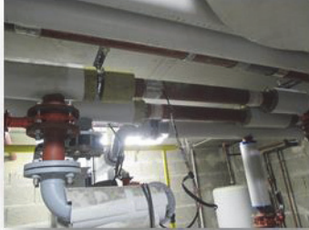
Figure 4 : Capteurs de monitoring de structures tubulaires via la technique des ondes ultrasonores guidées installés en l'occurrence dans une chaufferie, dans les locaux de l'Institut de Soudure de Yutz (57).
