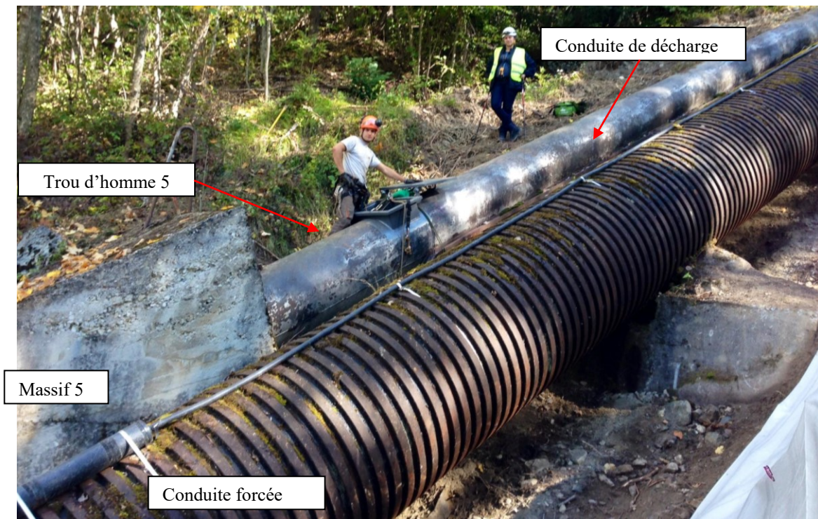
Figure 5 : Photo de la conduite forcée et conduite de décharge au premier et second plan respectivement.
